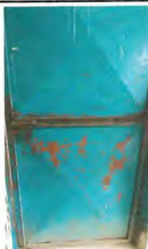
Foto 3: Se observa el desgaste de de las puertas 1 aula del modulo 2; 2 aulas del módulo 3 y 1 aula del módulo 4.
